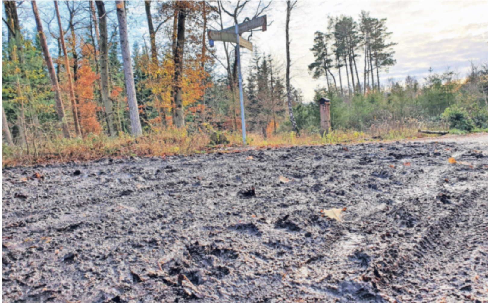
Waldarbeiten könnten die Erde im Bereich der Kreuzung Breite Allee und Neuer Weg zusätzlich aufgewühlt haben.
